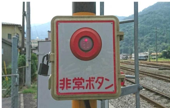
【踏切支障報知装置（非常ボタン）】
