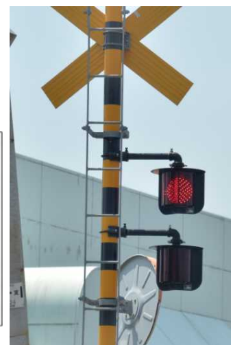
【全方向踏切警報灯】
