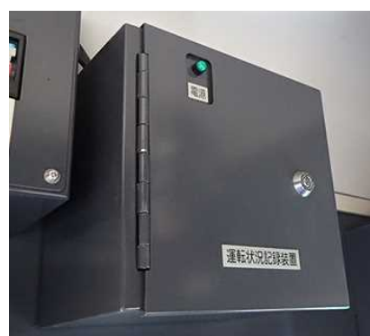
【運転状況記録装置】
