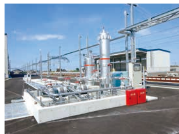
列車給油設備
