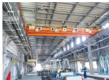
天井クレーン
