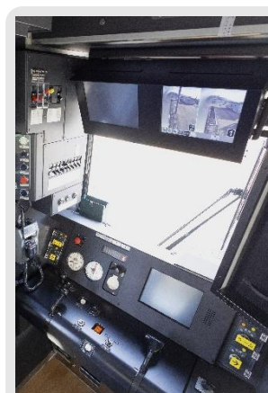
ホーム確認運転台モニター
